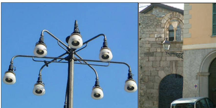
Fig. 25 – Esempio di messa a norma di impianti d'illuminazione d'epoca: con semplici e poco costose schermature (foto di sinistra) oppure, nel caso della foto di destra, ricondizionando antiche lanterne e facendole rientrare nella deroga dei 15 cd/klm a 90° ed oltre.
